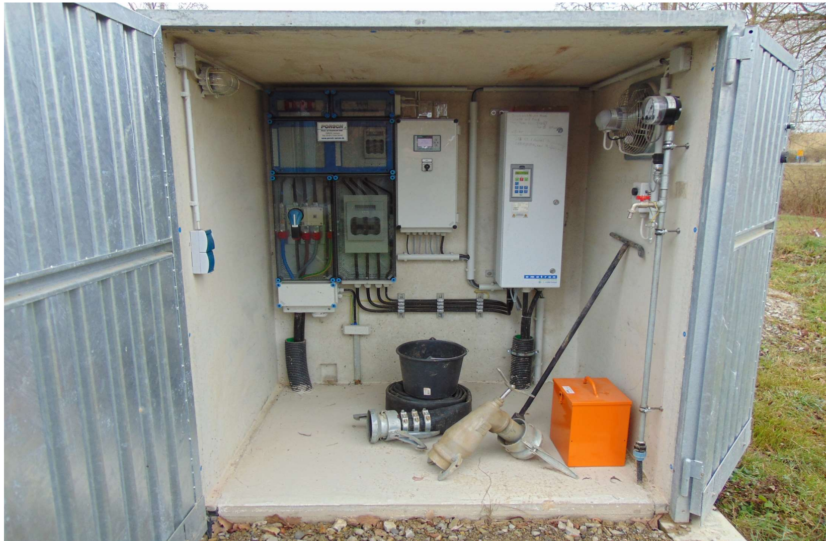
Bewässerung in Südniedersachsen
